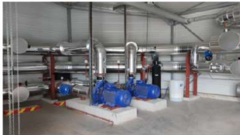
Les hydrocondenseurs permettent de récupérer la chaleur de l'air pour chauffer l'eau qui circulera dans les serres. ©RCF Anjou
