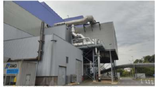
A la sortie de la turbine de l'incinérateur, l'air est encore à 55°C. ©RCF Anjou
