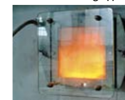
Le chef de quart vérifie la couleur de la flamme, la hauteur et la régularité de la couche de déchets pour optimiser la combustion.
