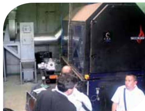
Les élus de SIVERT découvrent le fonctionnement de la chaufferie à bois de Lorient.
