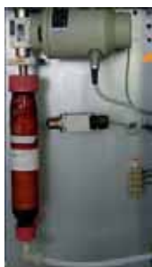
Système AMESA (contrôle des fumées)
